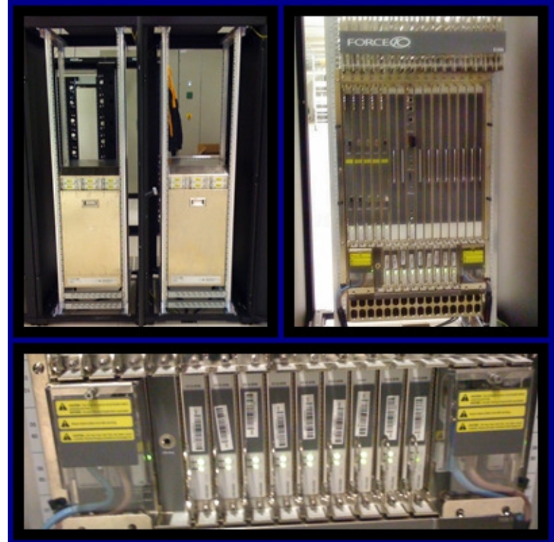
Photos de la première installation à INTX5
